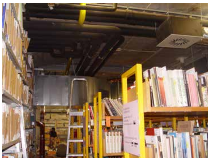
Skozi kletno skladišče potekajo številne cevi. (foto Jana Zeni Bešter)
