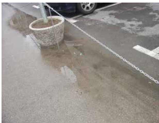
Stanje nad skladiščem na tleh v okolici vdora vode ob deževnem vremenu. (foto Kristina Košič Humar)
